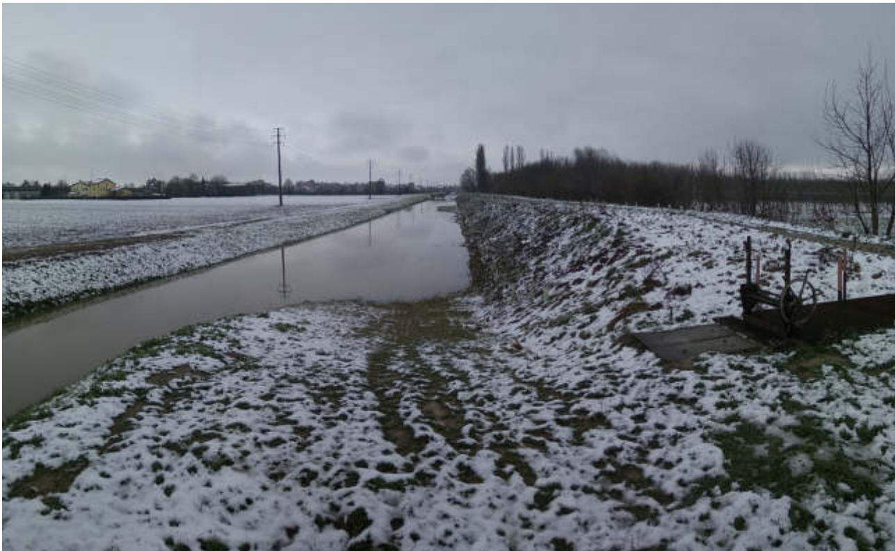
Figura 44- Allagamento della banchina durante un evento di piena (2018)
