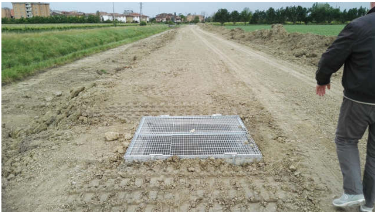
Figura 41 - Diversivo Fossa Nuova Cavata – Pozzetto ispettivo a servizio della tubazione sostitutiva del Condotto Gusmea (2016)
