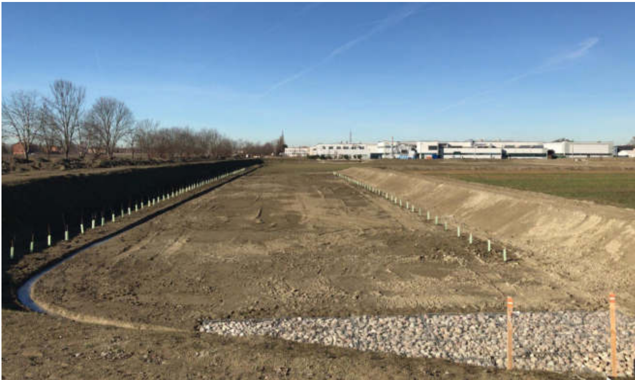
Figura 69 – Cassa di espansione a servizio della Cavata Orientale. In primo piano il lembo di cassa che si raccorda con la tubazione di uscita. Si notano gli shelter a protezione della fascia arbustiva messa a dimora lungo gli argini perimetrali. (Inizio 2019)
