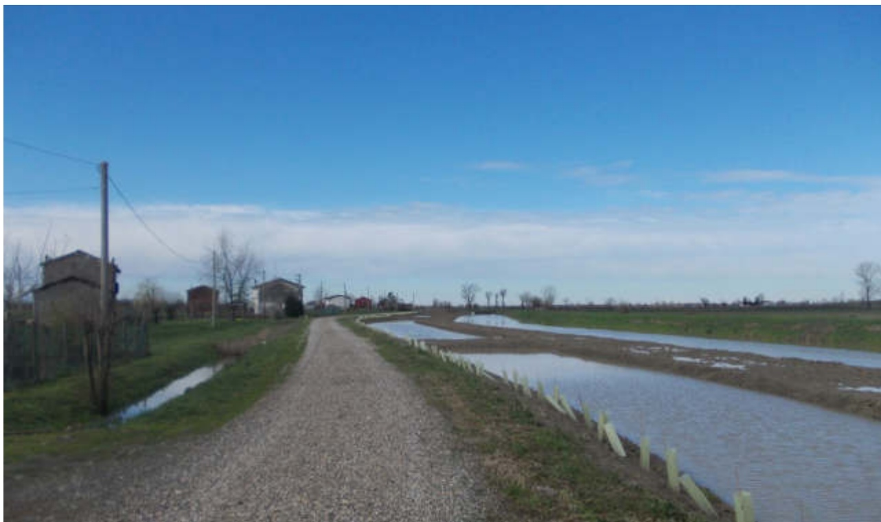
Figura 25 – Collettore Alfieri a due mesi dagli scavi: prime piogge. Particolare di una bassura umida (febbraio 2016)
