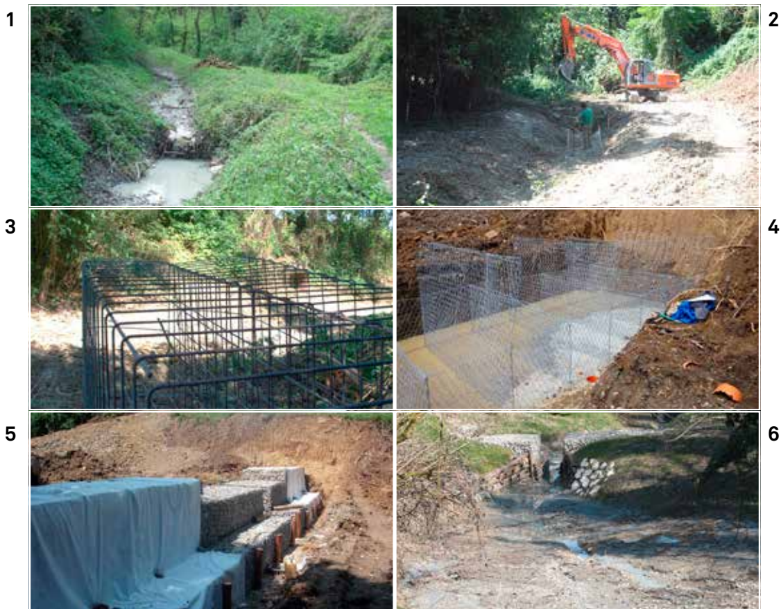
Figura 10 – Sequenza delle fasi di realizzazione del restringimento di sezione in pietrame in corrispondenza di un intervento di allargamento e ricreazione di piana inondabile sul Rio Bianello.
