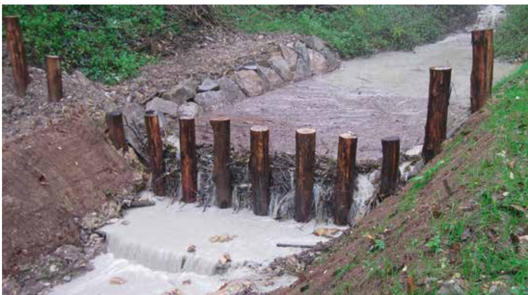
Figura 16 – Schema tipologico e foto di una briglia selettiva realizzata sul Rio Bianello nell’ambito del progetto Life RII. Si noti l’accumulo della ramaglia a monte dell’opera, che dovrà essere svuotata periodicamente per evitare il completo intasamento.
