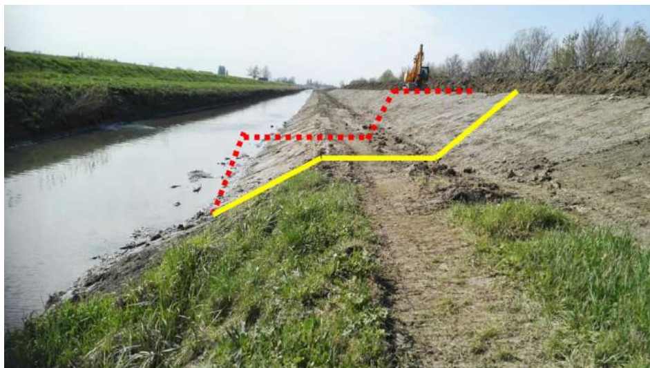
CABM al termine dei lavori di scavo (vista da valle verso monte) (in rosso la sezione originale e in giallo la sezione di progetto, ampliata in termini di profondità e larghezza)
