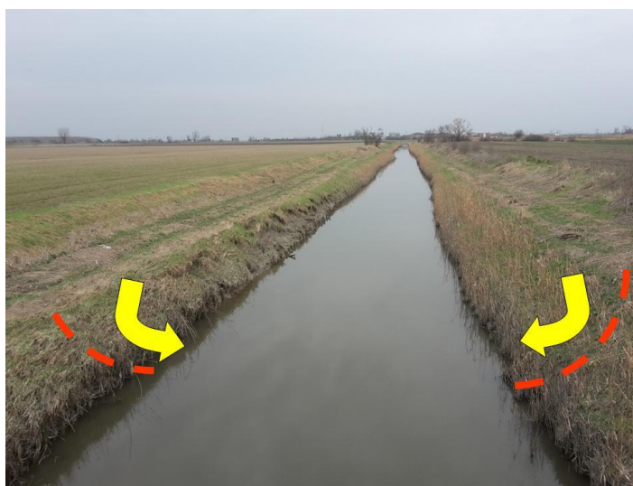
Figura 13 - Necessità di continuare a garantire la stabilità della sponda
