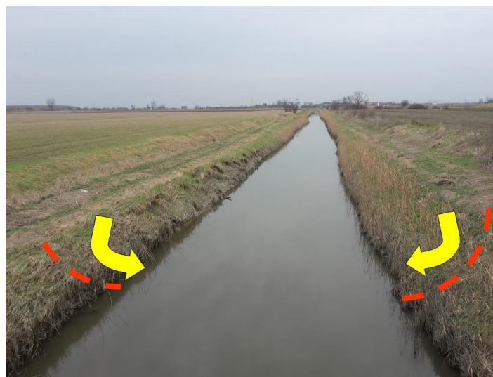
Figura 15 - Necessità di continuare a garantire la stabilità della sponda
