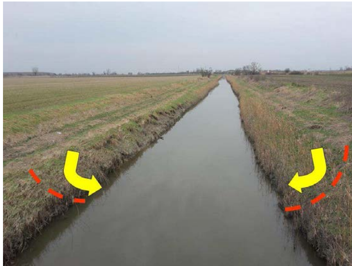
Figura 24 – Esempio della necessità di continuare a garantire la stabilità della sponda
