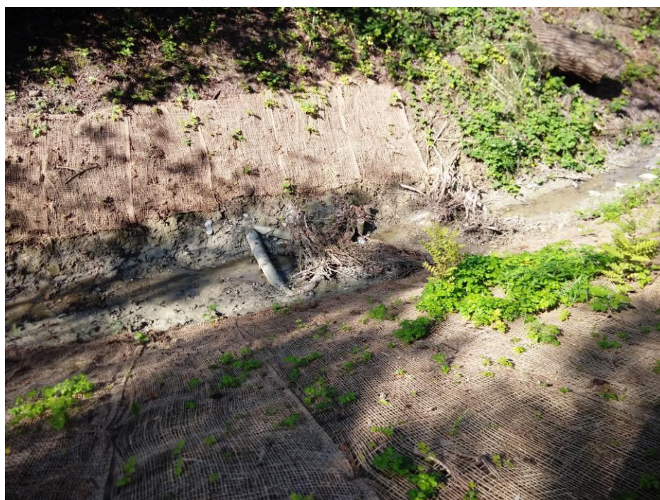
Figura 27 – Il salto di fondo naturaliforme con radici esposte nell'alveo del Rio Bottazzo al termine della sua realizzazione.
