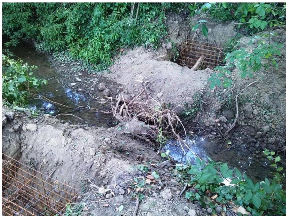
Figura 21 – Realizzazione di un salto di fondo naturaliforme a radici esposte realizzato sul Rio Arianna.
