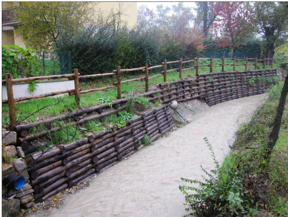
Figura 16 – La palizzata realizzata sul Rio Lavezza durante le piogge di fine ottobre 2014.
