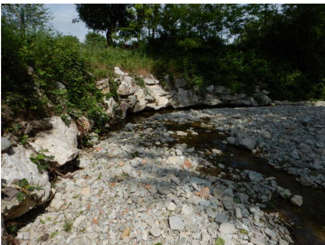
Figura 19 - Difesa spondale in massi preesistente
