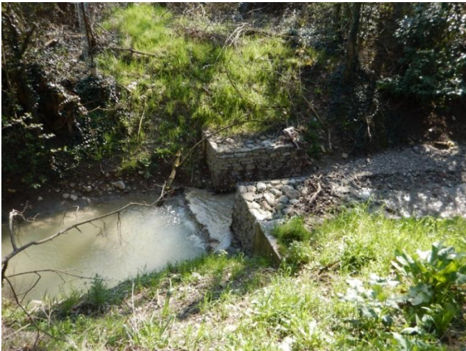
Figura 19 - Restringimento in pietrame
