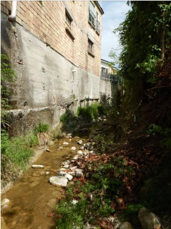
Figura 18: Assenza di fascia perfluviale con edificazioni in sponda al rio
