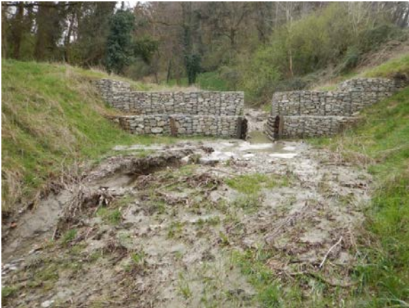
Figura 6: Restringimento in pietrame
