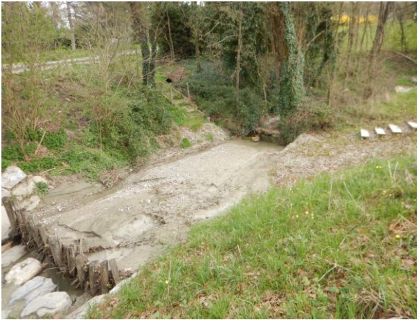
Figura 9: Deposito di materiale a monte della briglia
