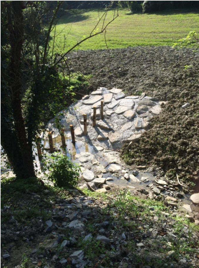
Figura 21: Briglia selettiva (sopralluogo ottobre 2014)
