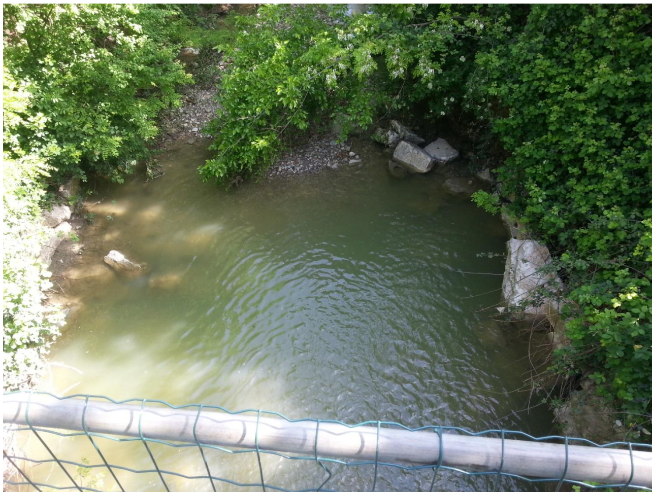
Figura 18 – Punto critico 1 del Torrente Lodola - Ponticello pedonale, briglia ammalorata e destabilizzazione spondale.
