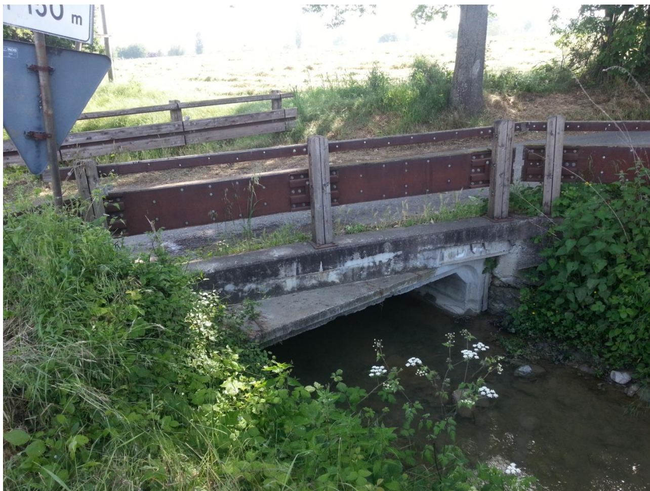
Figura 13 – Punto critico 1 del Rio Lavacchiello – Ponte che crea problemi idraulici.
