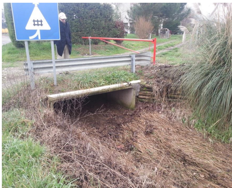
Figura 76 - Punto critico 1 del Rio Montefalcone – Uscita del tratto tombato di Piazzola.
