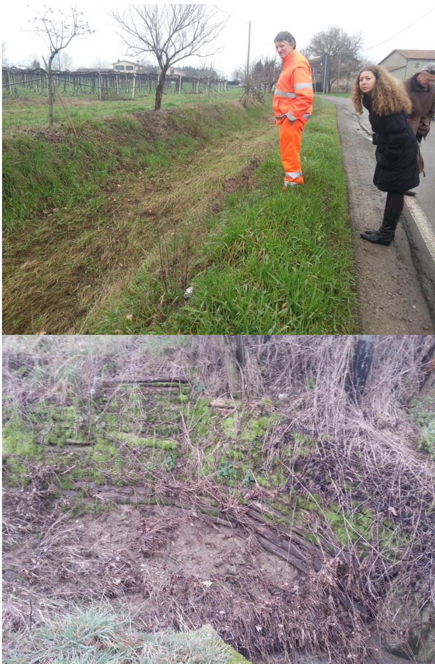
Figura 82 – Punto critico 2 del Rio Montefalcone - Tratto risagomato a valle del tratto tombinato di Piazzola: in basso, particolare della palificata ammalata.
