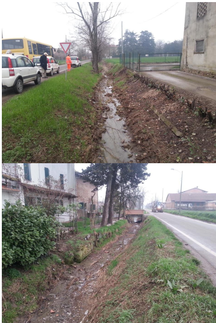
Figura 92 - Punto critico 3 del Rio Montefalcone. Vista verso valle (sopra) e verso monte (sotto) della situazione di degrado e dissesto della sponda destra.
