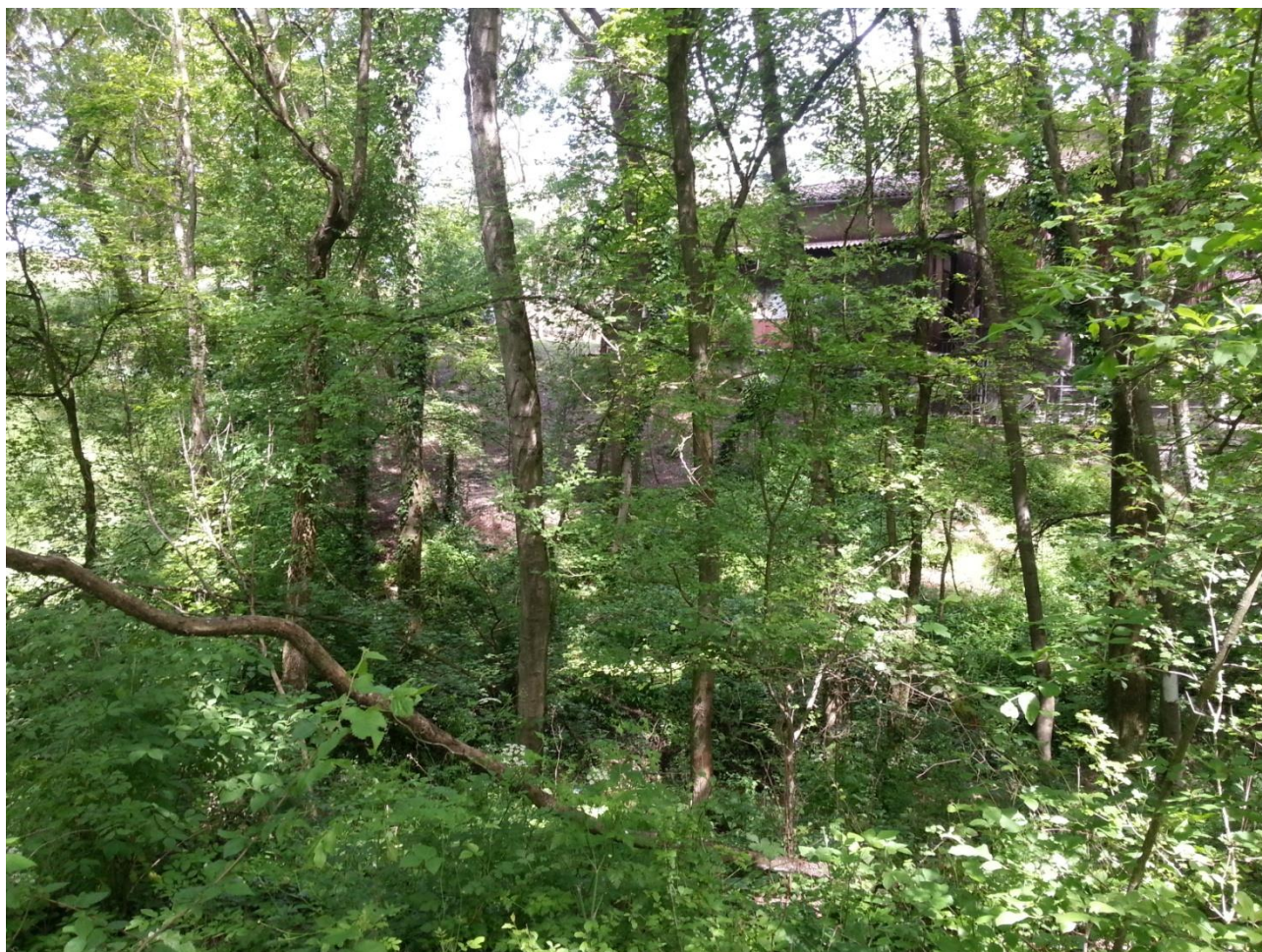
Figura 28 - Punto critico 3 del Rio della Chiesa. Versante potenzialmente instabile in sinistra idraulica.
