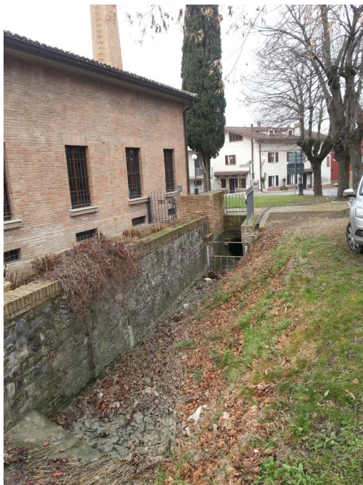
Figura 43 – Punto critico 1 del Rio Bianello – Inizio del tratto tombato.
