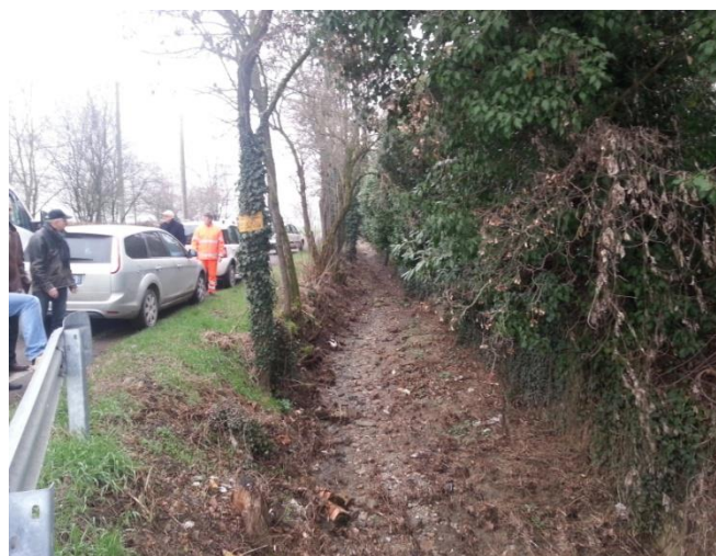
Figura 94 - Punto critico 3 del Rio Montefalcone. Sezione insufficiente e abitazione in fregio al rio.
