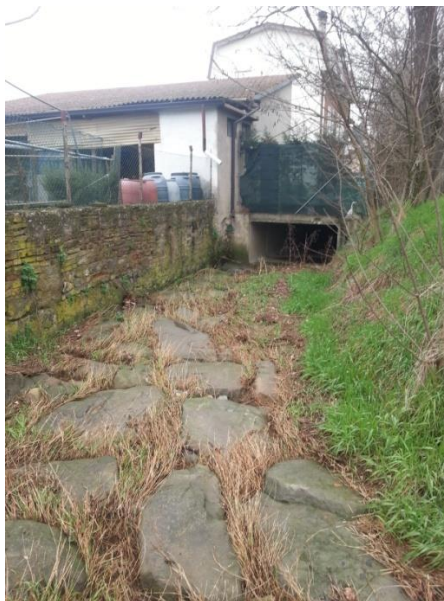
Figura 75 – Punto critico 1 del Rio Montefalcone – Imbocco del tratto tombato di Piazzola.
