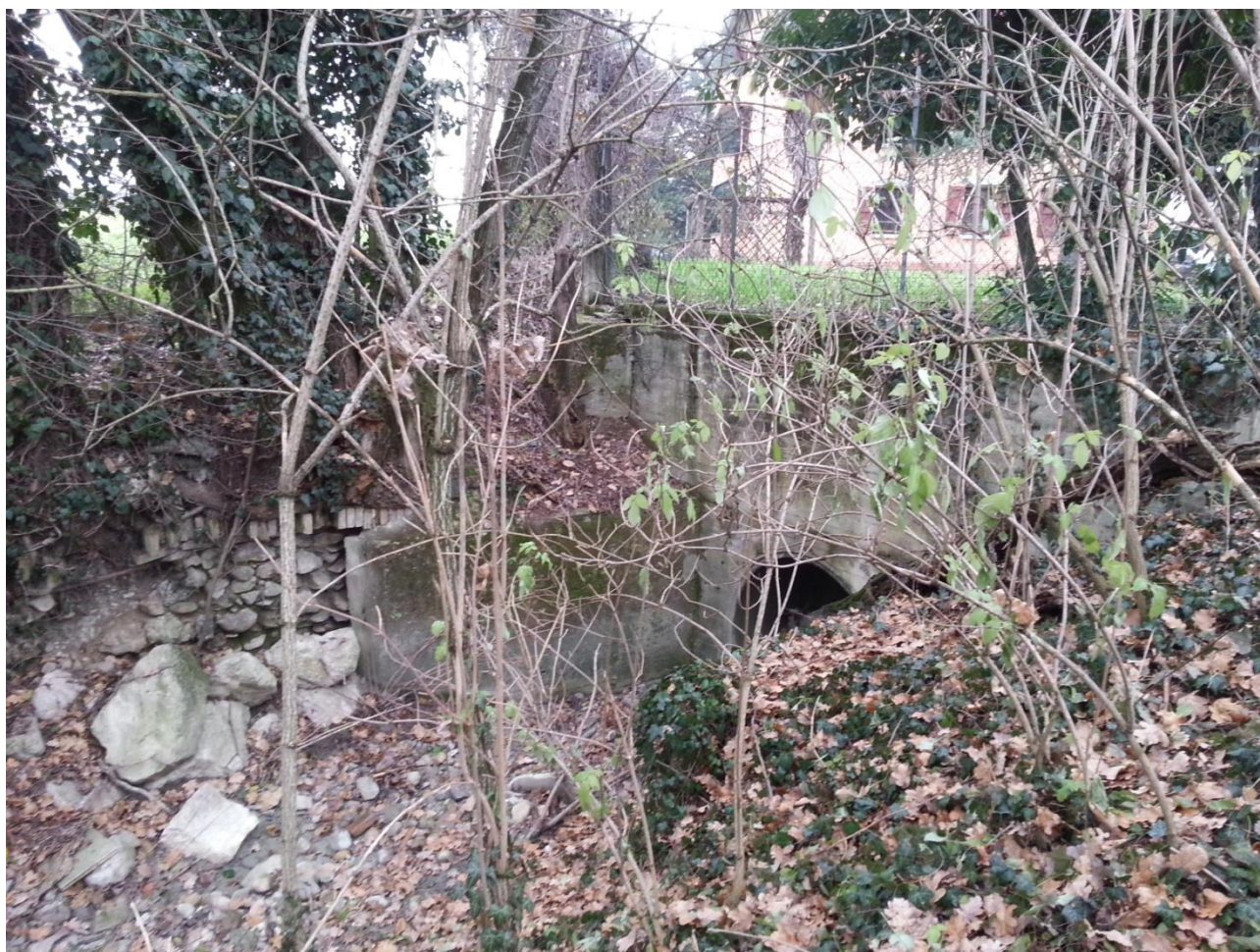
Figura 49 – Punto critico 1 del Rio Monticelli – Tratto tombato.
