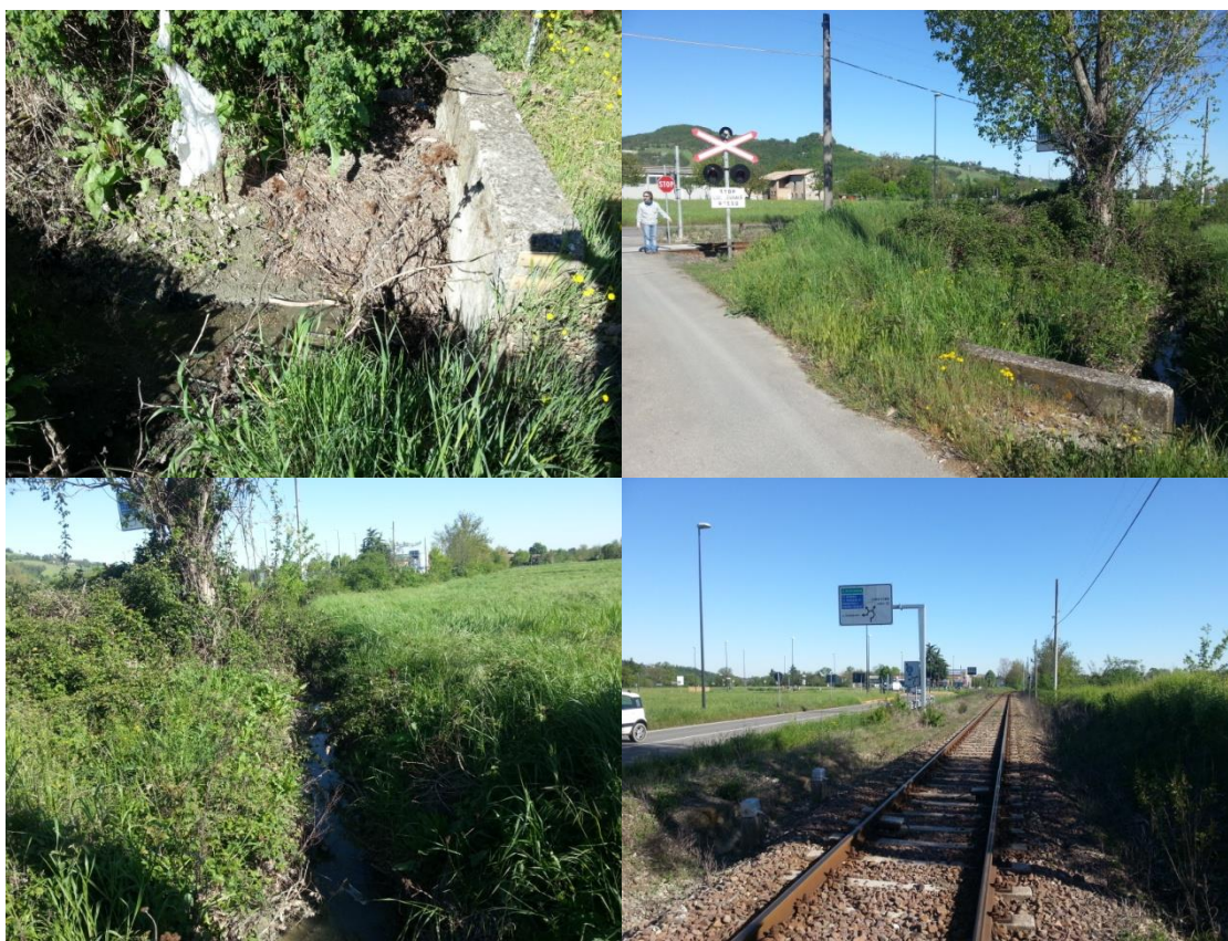
Figura 123 - Punto critico 1 del Rio Fontaneto. In alto a sinistra: imbocco occluso del ponticello; in alto a destra: rio a valle del ponticello, con la ferrovia in sinistra; in basso a sinistra: vegetazione presente lungo il tratto di rio a valle del ponticello; in basso a destra: ferrovia e, a destra, rilevato arginale in sinistra idraulica del rio.
