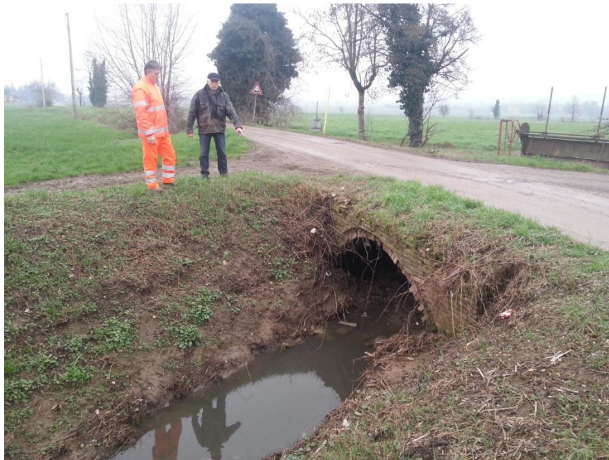
Figura 87 - Punto critico 3 del Rio Montefalcone. Ponte di attraversamento del rio e strada che ha costituito nel recente passato la via di deflusso principale delle piene verso Corniano.
