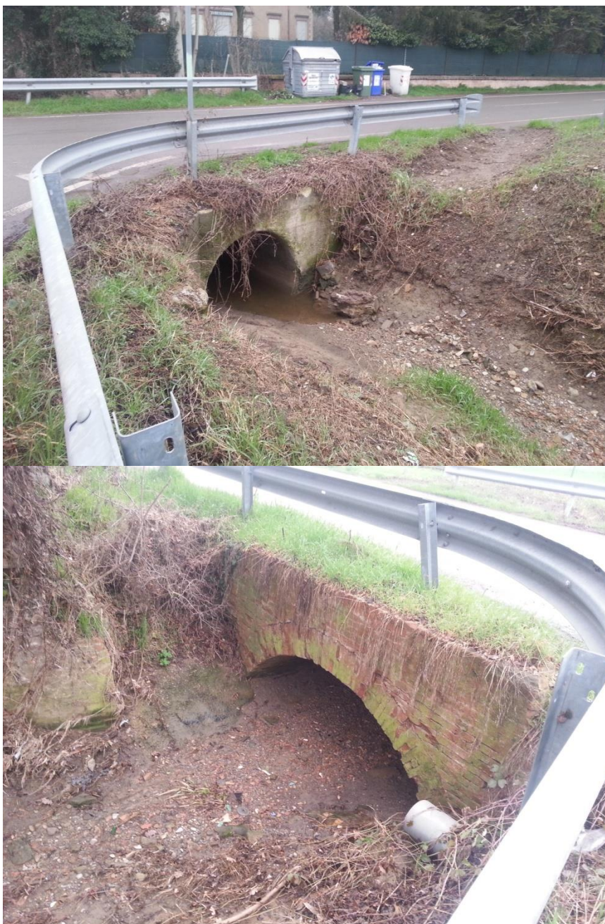
Figura 95 - Punto critico 3 del Rio Montefalcone. Vista verso valle (sopra) e verso monte (sotto) del ponte con luce insufficiente.
