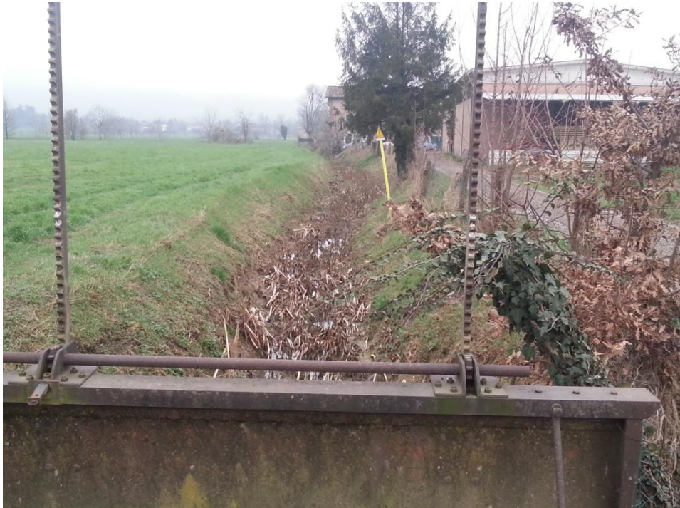
Figura 86 – Punto critico 3 del Rio Montefalcone. Vista verso monte (sopra) e verso valle (sotto) realizzata dal ponte mostrato in Figura 87.
