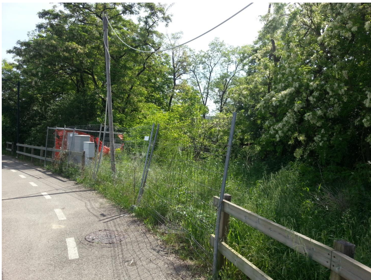
Figura 4 – Punto critico 1 del Torrente Lavezza – Versante in sinistra idraulica instabile.
