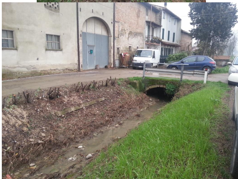
Figura 91 - Punto critico 3 del Rio Montefalcone. Vista verso valle (sopra) e verso monte (sotto) del ponte con luce insufficiente.
