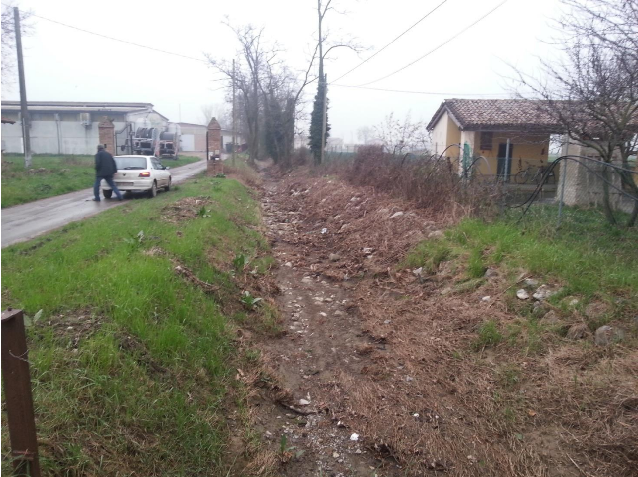
Figura 99 - Punto critico 7 del Rio Montefalcone. Tratto a monte della deviazione dell'alveo storico del rio, soggetto a sedimentazione e conseguente innalzamento del fondo ed esondazioni in destra idraulica.
