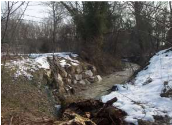
Figura 6 Erosione del rio Lavezza in corrispondenza del campo sportivo, mitigata con intervento tradizionale
